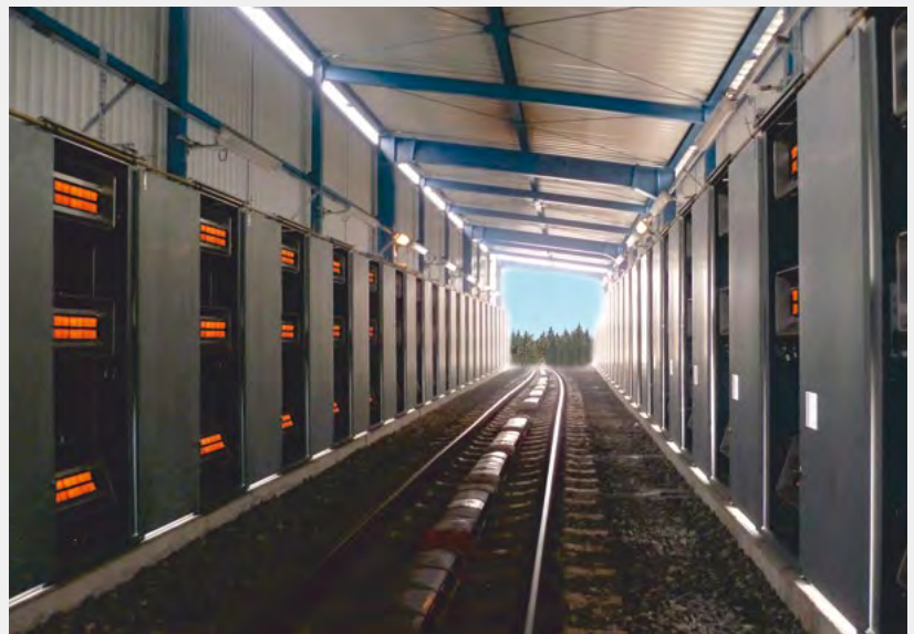
GoGaS Waggonauftauanlage: Optimal ausgerichtete Strahler für effiziente Wärmeverteilung
